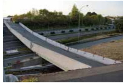
九州自動車道に崩落した県道の陸橋 4月17日、甲佐町
