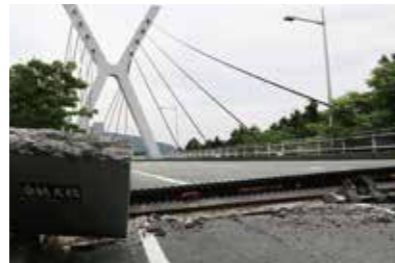
橋桁と橋台がずれた桑鶴大橋 4月21日、西原村
