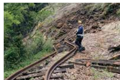
崩落した土砂に巻き込まれ曲がった南阿蘇鉄道の線路
