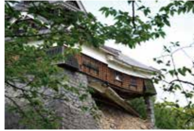
石垣が崩れ今にも崩れ落ちそうな熊本城飯田丸五階櫓 4月16日
