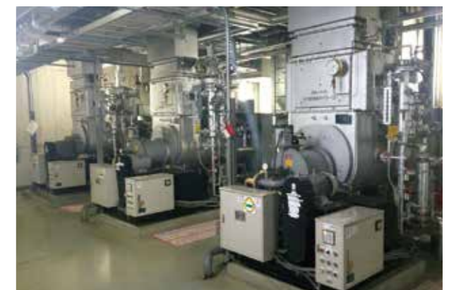
灯油燃料ボイラー
