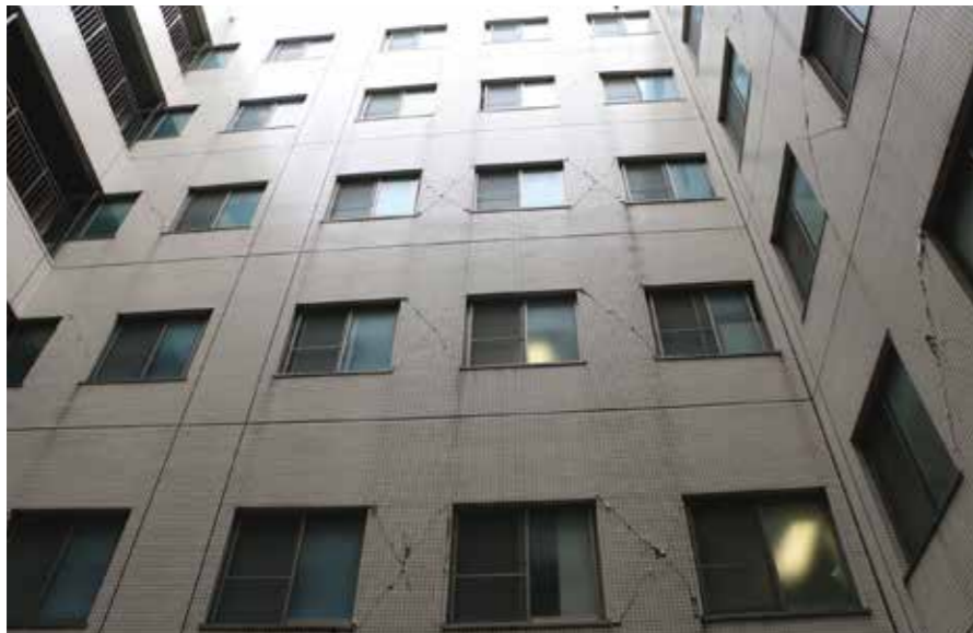
3階検査室前中庭の外壁。複数のX字状ひび割れが見られる
