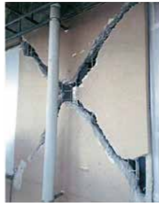
X字状に大きく割れた 病棟外壁の雑壁
