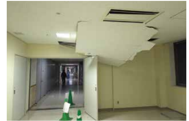
食堂横の天井も崩落
