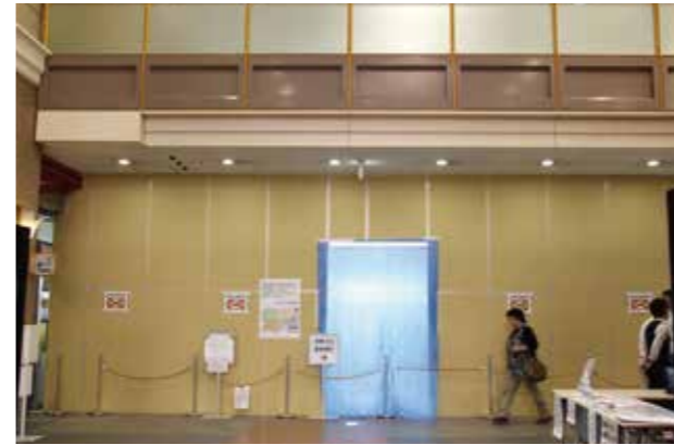
天井崩壊危険のためショッピングモールを封鎖（～6月26日）
