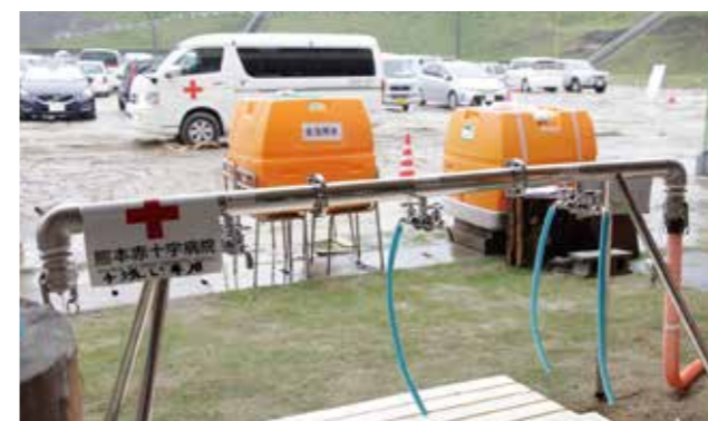
手洗い設備 益城町総合体育館避難所
